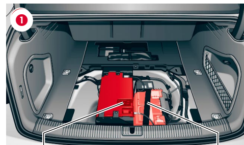
Batería de 48 voltios
